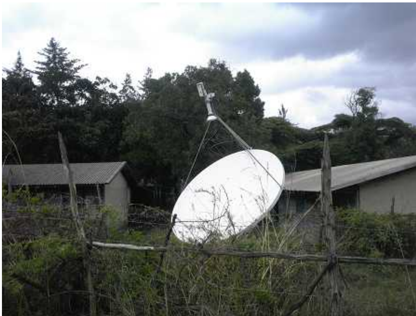
写真 1: エチオピアの田舎の学校に設置された VSAT アンテナ
